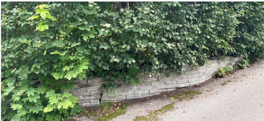
Kuva 12. Kuvan tukimuurin on tehty ladottavista kivilöykkyistä, joita ei voi sitoa tukevaksi rakenteeksi. Tukimuuria ei myöskään ole perustettu kunnolla. Kuvassa näkyvä kivityyppi soveltuu vain hyvin mataliksi reunuksiksi.
