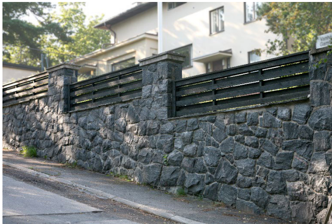
Kuva 2. Kuva on asemakaavassa suojellulta alueelta, jossa kaava edellyttää tontin rajaamista muurein, istutuksin tai aidoin. Vanha muuri on pidetty kunnossa ja puuosia on uusittu vuosien varrella.
